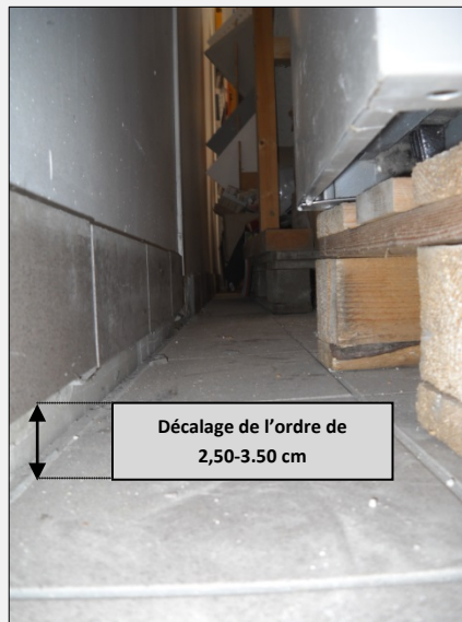
Affaissement du dallage
