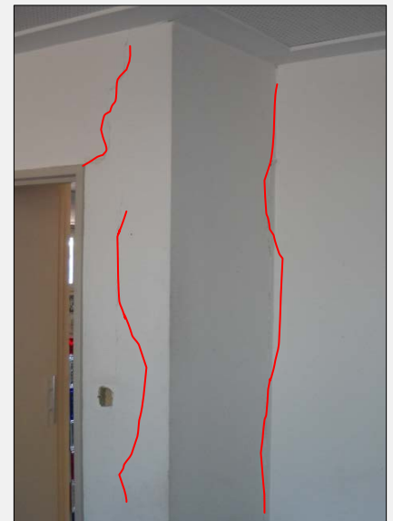
Fissures sur les murs intérieurs
